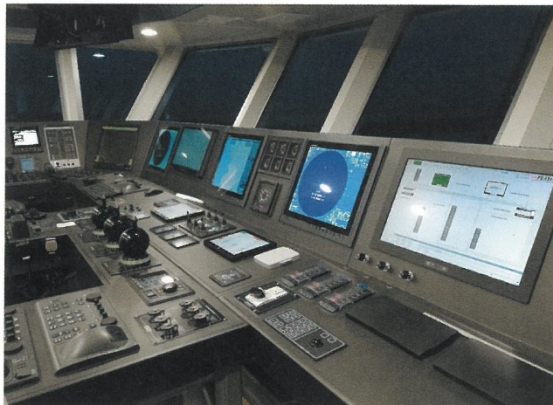
Apparati Furuno installati a bordo dell'unità HSC Jumbo Jet
